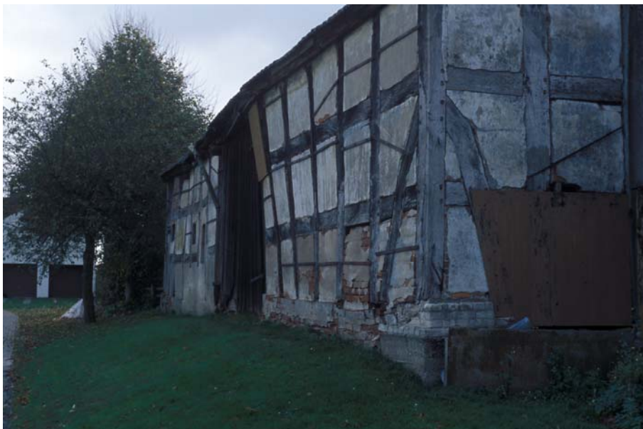
Abb. 9: Am Eckständer der Scheune zeigen sich, obwohl das Gebäude auf einer künstlich aufgeschütteten Fläche gebaut wurde, erhebliche Bauschäden, die auf Überflutungen und den feuchten Untergrund zurückgehen.
