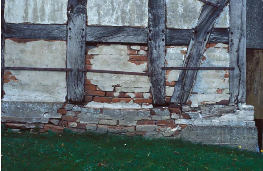
Abb. 10: Detail der Schäden an der Scheune,
